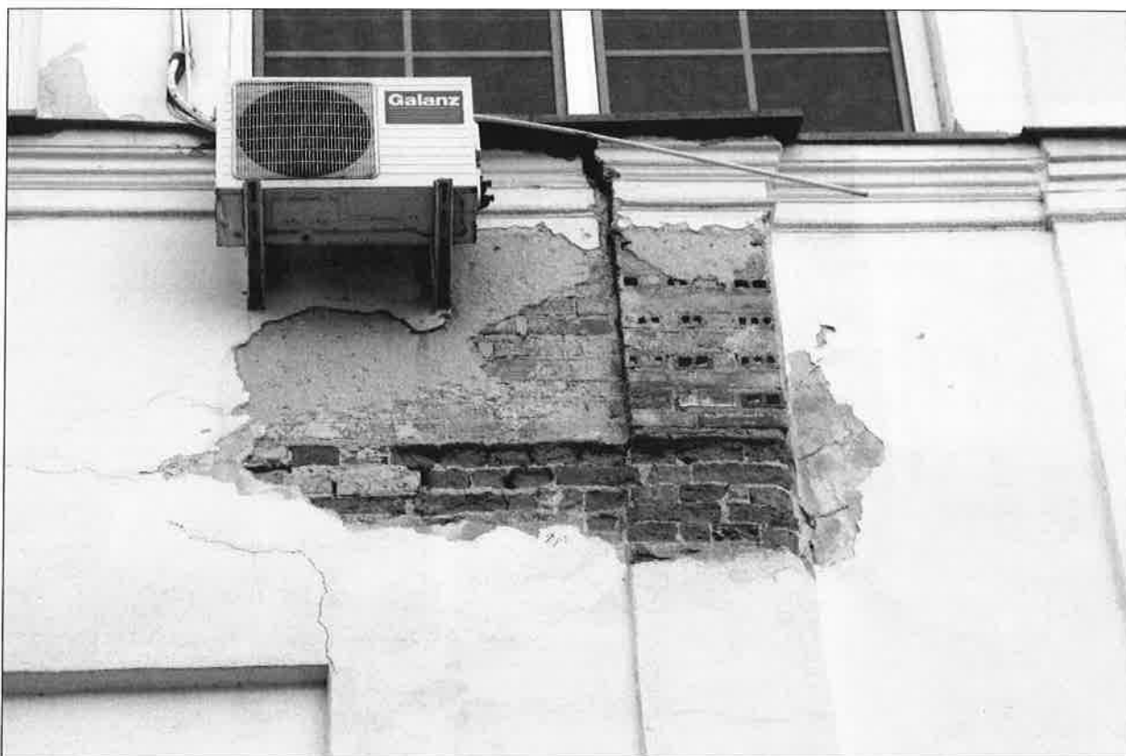
Il. 9. Widok różnicy materiałów konstrukcji murów pomiędzy drugą i trzecią kondygnacją budynku.
