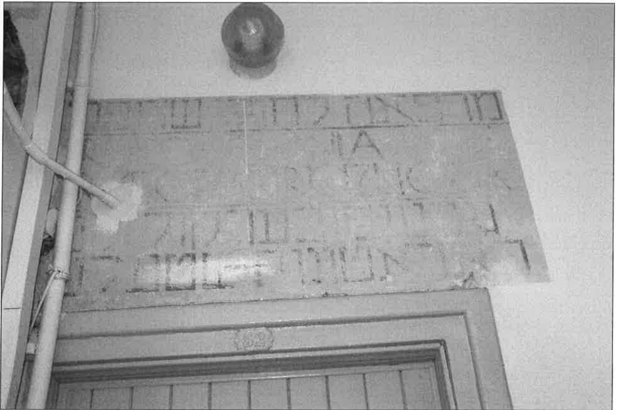
Il. 17. Zabytkowy napis informujący o ambulatorium przeciwgruźliczym znajdujący się we wnętrzu wschodniej klatki schodowej budynku.
